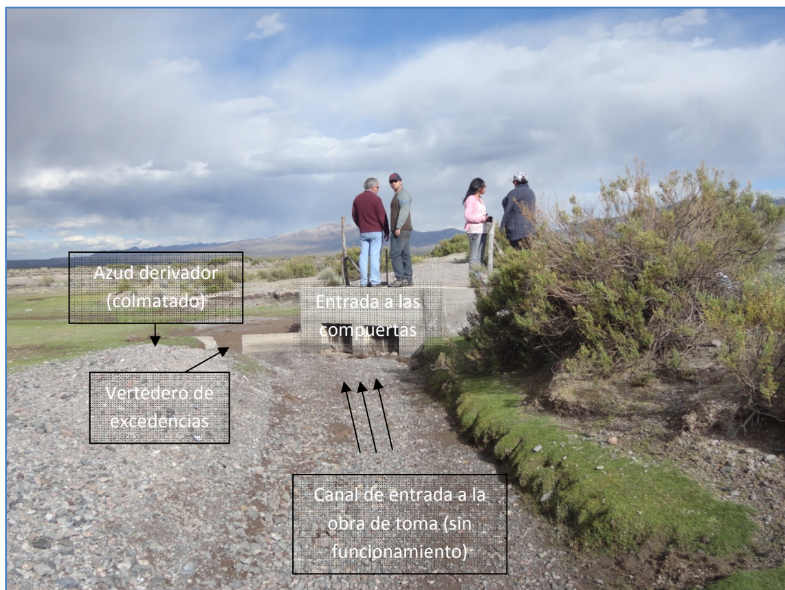
Figura 9. Obra de toma de derivación directa, con azud derivador. La obra se encuentra sin funcionamiento, aparentemente debido a la incorrecta orientación del azud derivador (fuera del eje del curso natural del Río Sajama, ver Figura 10), y al excesivo arrastre de material en suspensión (ver Figura 11).
